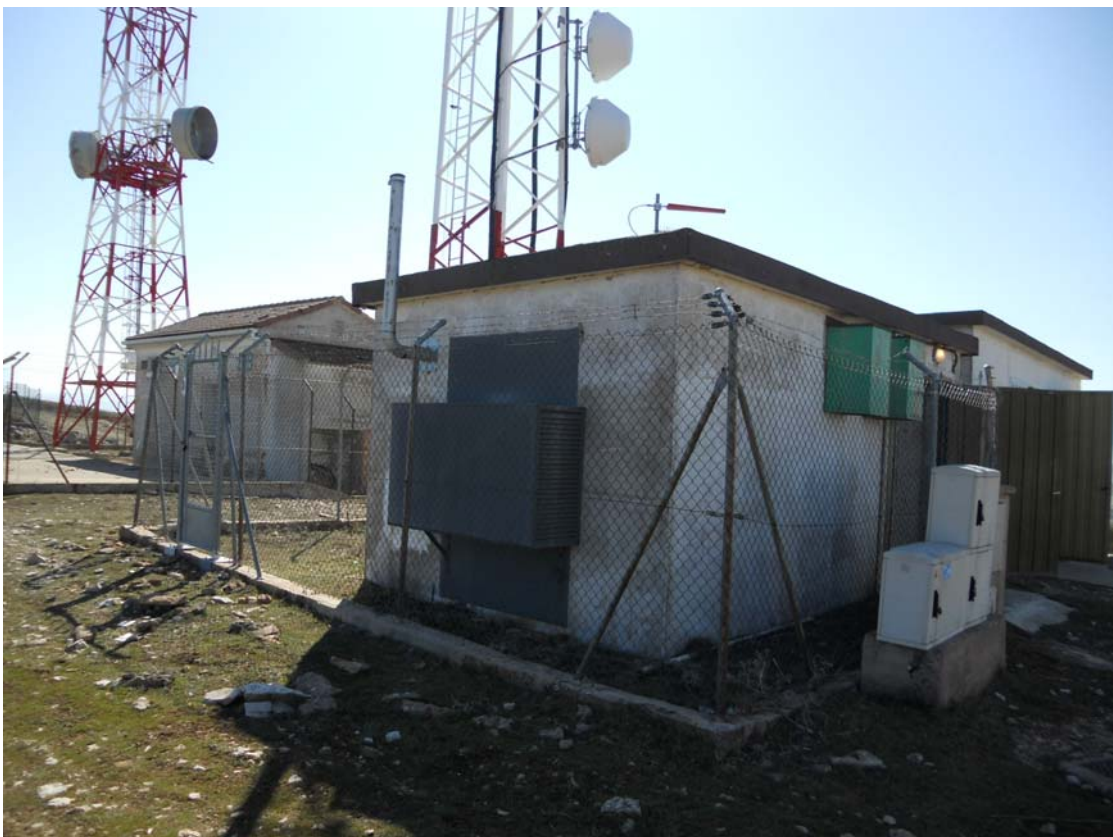
Caseta grupo electrógeno
